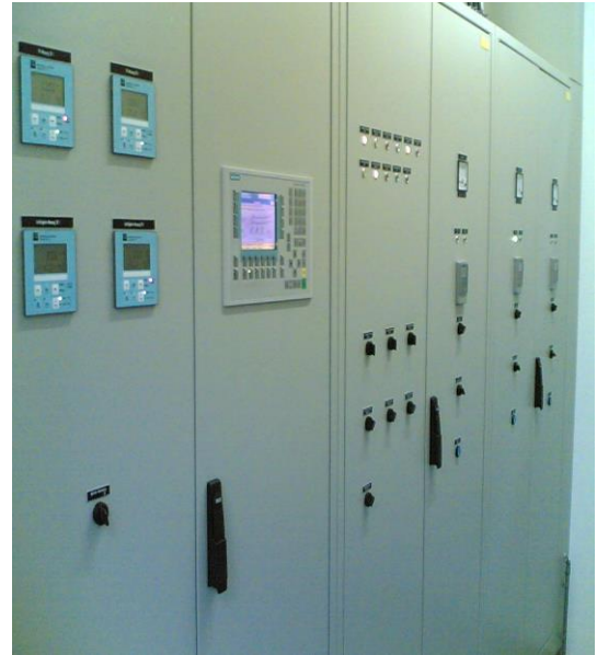
Steuerungsschrank für Pumpanlage
