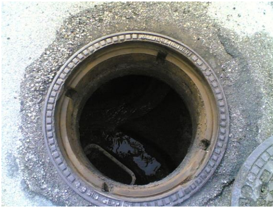
offener Schacht auf der Straße
